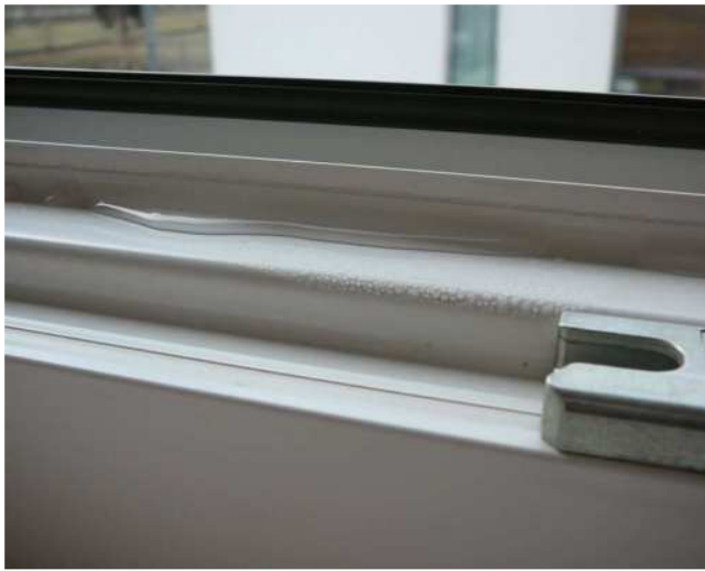
Wasser im Falz
